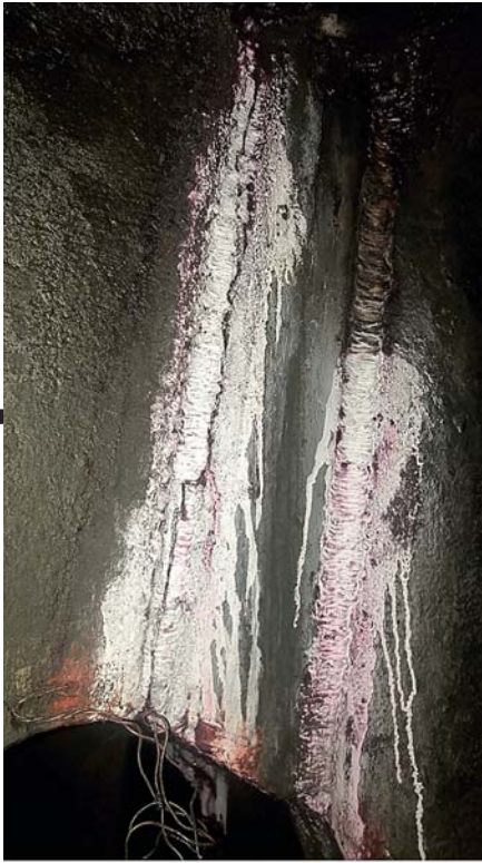
Рис. 5. Трещина длиной 500 мм в основании пресса усилием 100 МН УЗТМ
